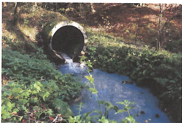
Betonowa rura, z której pochodzą ścieki
